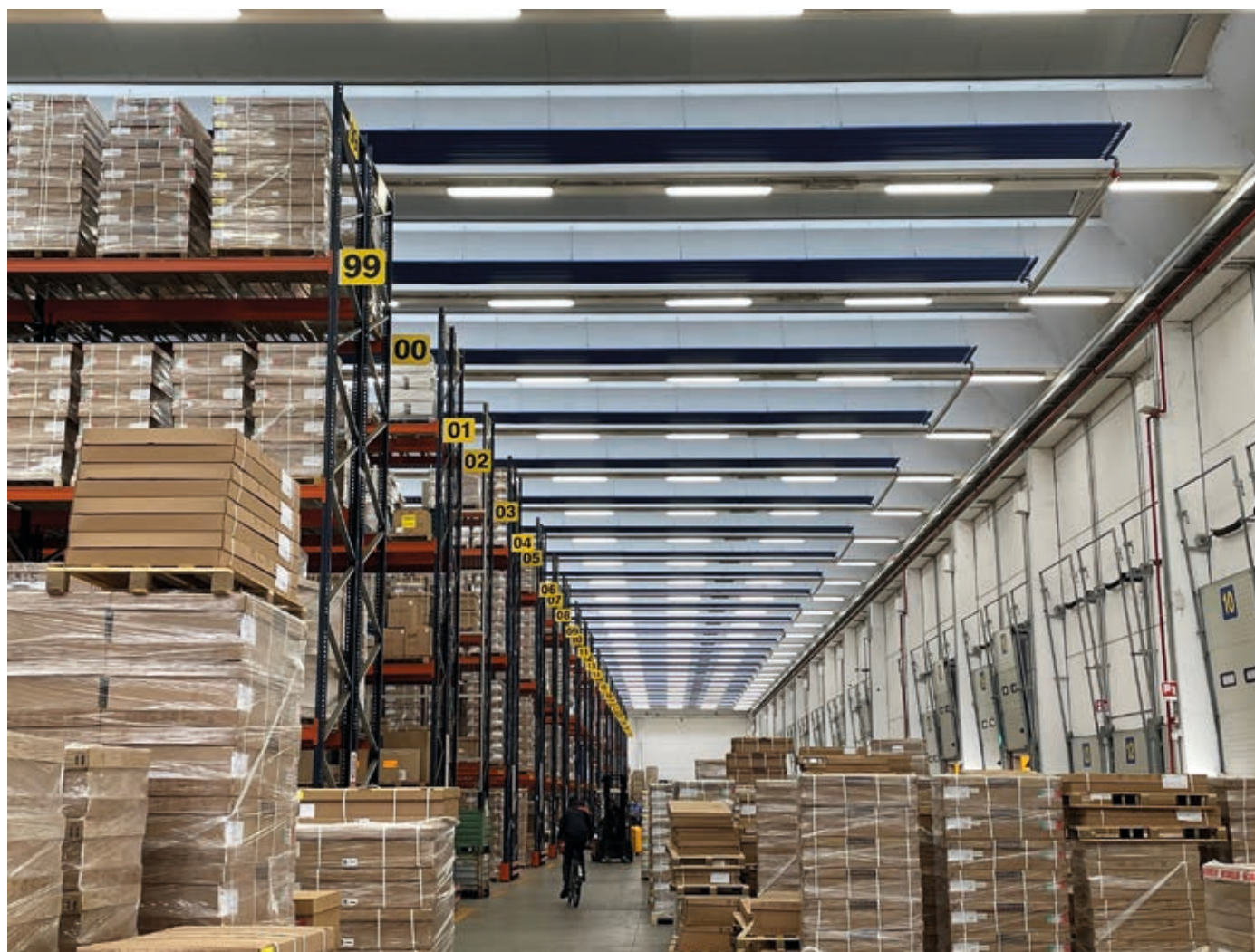
Instalación de calefacción con paneles radiantes SABIANA en el almacén de SABIANA (Italia).
