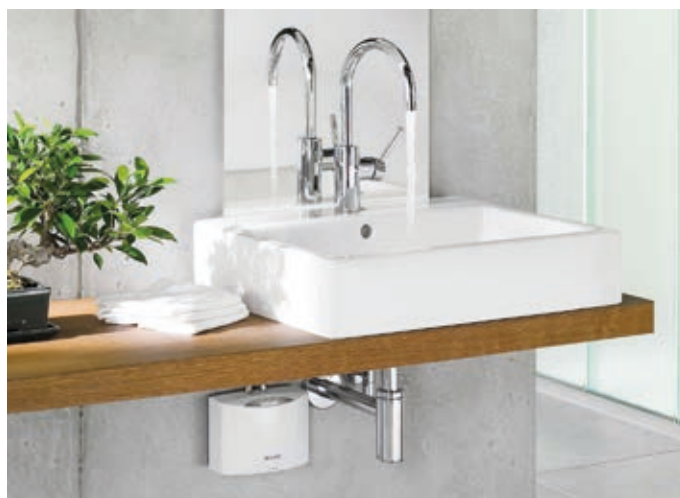
Instalación de CLAGE MCX para lavabo
