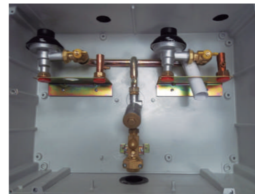
ARMARIO A-10, Caudal 10 m 3 /h, con seguridad mín. 2 Contador G-4
