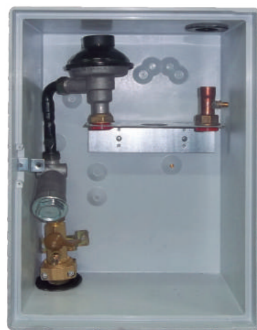
ARMARIO A-6 Caudal 6 m 3 /h Con seguridad de mínima. 1 Contador G-4
